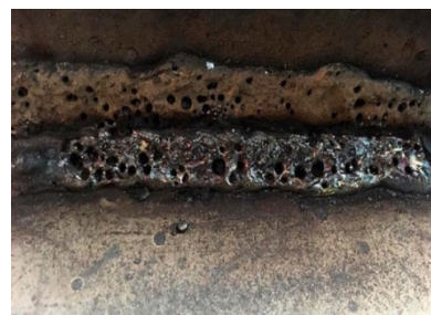
Фотография сварного шва с макро- и микродефектами
